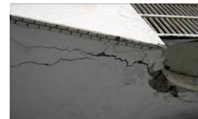
外牆鋼筋外露
